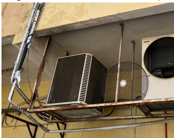
Figura 11 - Condensadora com Erro de Instalação
