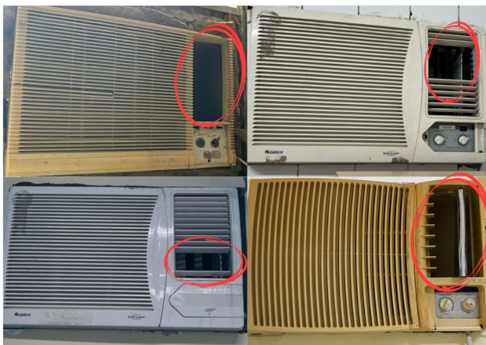
Figura 12 - Ausência de Aletas Direcionadoras de Ar
