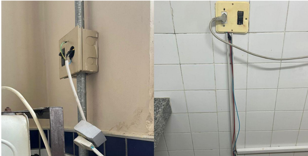
Figura 13 - Fiação Elétrica Exposta
