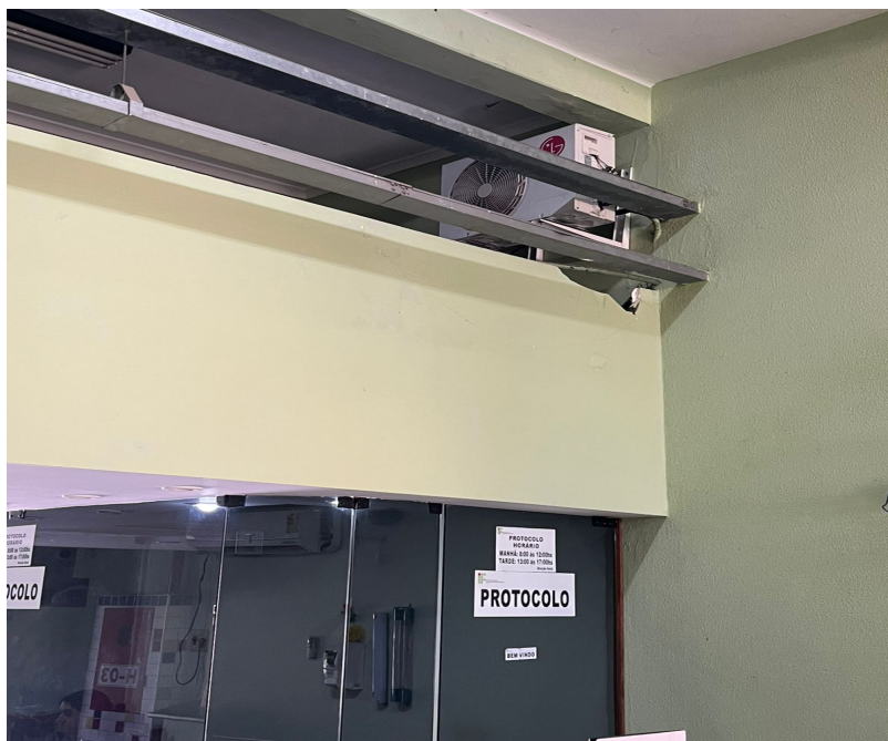
Figura 15 - Unidade Condensadora Instalada em Ambiente Fechado
