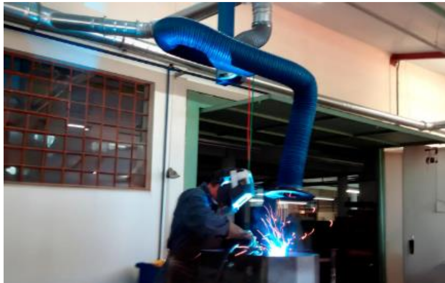
Figura 7 - Sistema de exaustão em processo de soldagem
