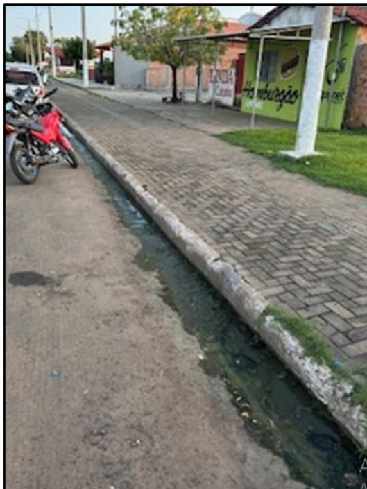
Foto 04: Esgoto despejado de forma incorreta na avenida
