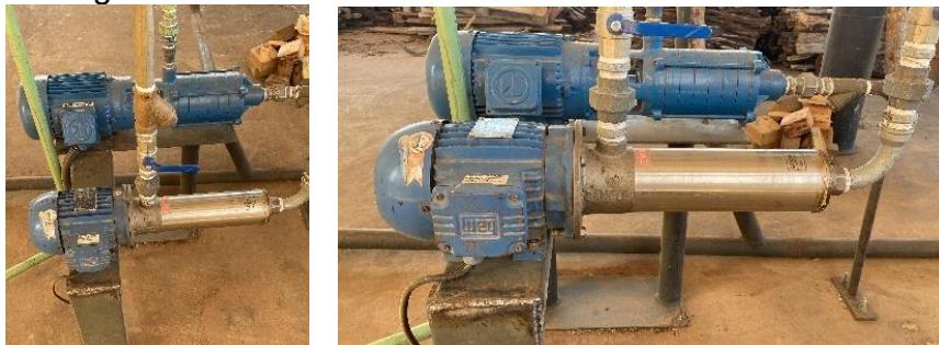
Figura 24- Detalhes das motobombas da caldeira.
