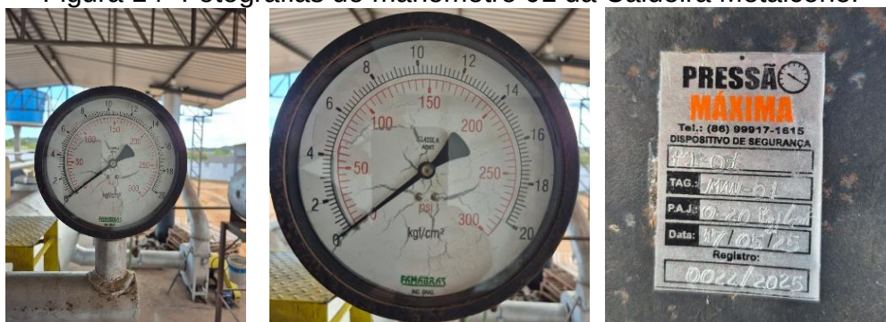
Figura 14- Fotografias do manômetro 01 da Caldeira Metalcone.
