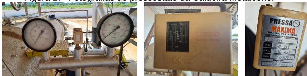
Figura 17- Fotografias do pressostato da Caldeira Metalcone.
