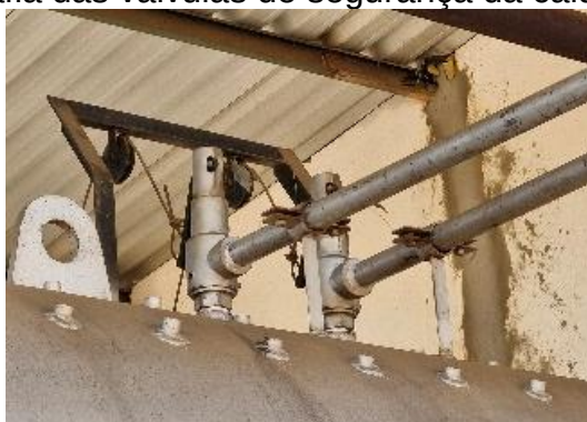
Figura 21- Fotografia das válvulas de segurança da caldeira Metalcone.
