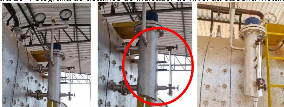
Figura 20- Fotografia de detalhes do indicador de nível da caldeira Metalcone.
