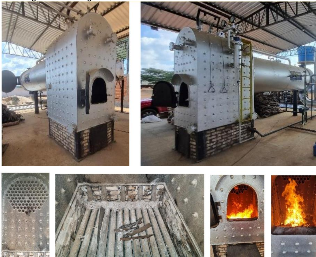
Figura 13- Fotografia da fornalha e cinzeiro da Caldeira Metalcone
