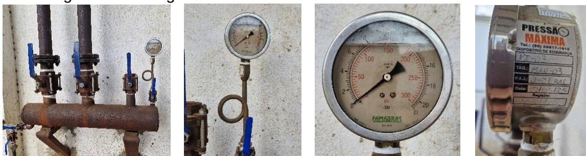
Figura 16 - Fotografias do manômetro 03 da Caldeira Metalcone.
