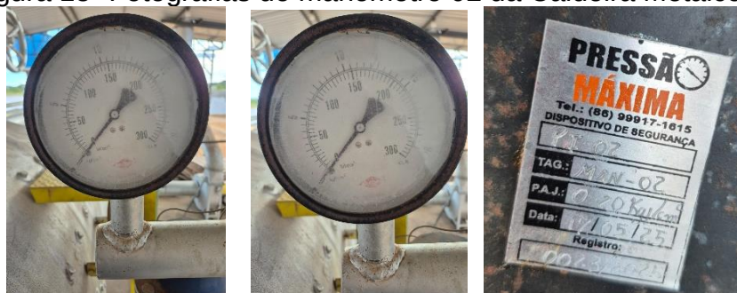
Figura 15- Fotografias do manômetro 02 da Caldeira Metalcone.
