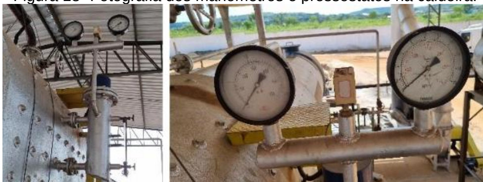
Figura 18- Fotografia dos manômetros e pressostatos na caldeira.
