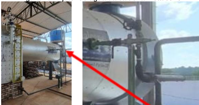
Figura 25- Injetor de água da caldeira Metalcone.
