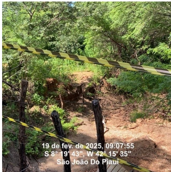
Figura 33 – Área degradada isolada por risco de acidentes; impacto na drenagem natural das microbacias
