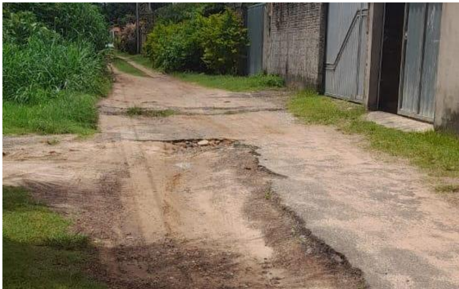
Figura 9 - Falta de pavimentação em uma rua no povoado Santa Rita
