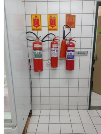
Figura 15 - Trio de extintores
