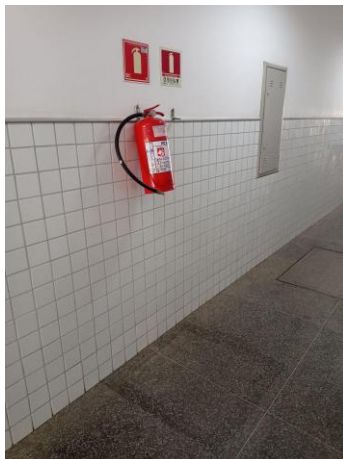
Figura 16 - Ausência de extintor de água
