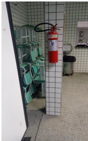
Figura 12 - Extintor sem placa de equipamento e sem demarcação no piso
