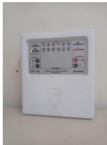
Figura 7 - Painel de alarme inoperante
