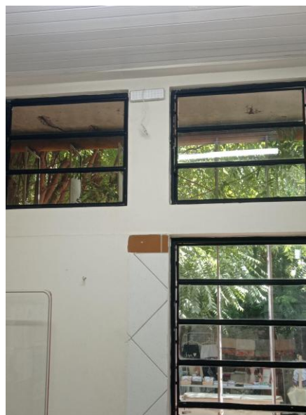
Figura 6 - Bloco autônomo de iluminação sem tomada
