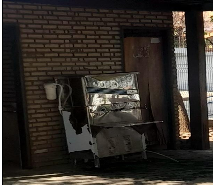
Figura 2: Condição do bebedouro do Parque da Macaúba
