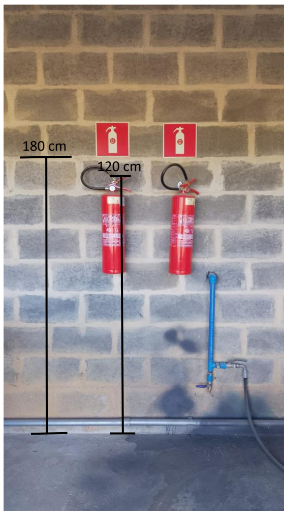
Figura 15 – Sugestão de instalação correta do extintor de incêndio, altura da placa de indicação e do manípulo do extintor.
