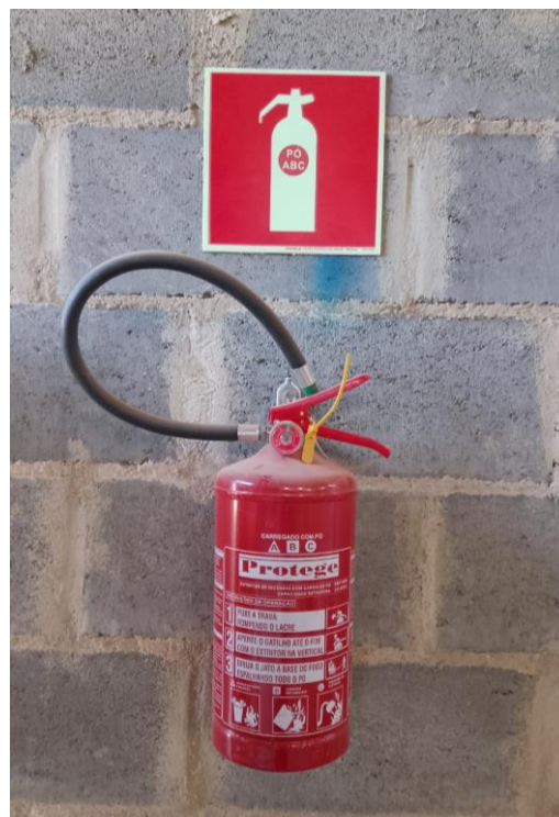
Figura 15 – Modelo de extintor utilizado nas dependências do galpão.
