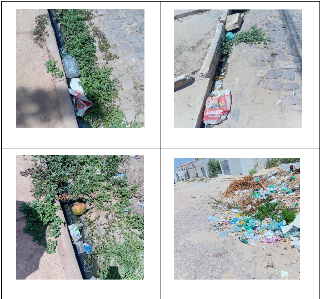
Figura 7 – Entupimentos de sarjetas
