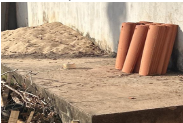
Figura 19: fossa séptica nas barracas da barragem do Bezerro (Ponto 51)
