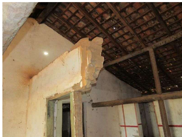
Figura 16 – Abalo na estrutura da parede
