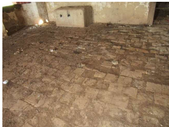
Figura 7 – Anomalias no piso
