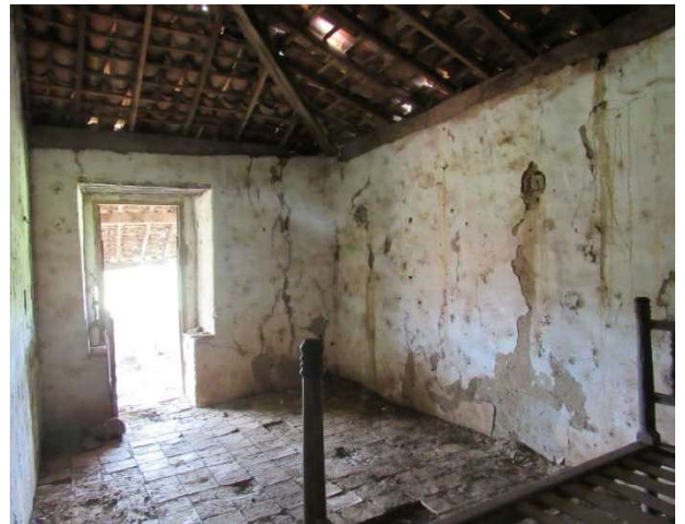
Figura 10 – Anomalias nas paredes
