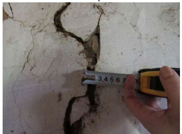
Figural 12 – Imagem aproximada da rachadura na parede
