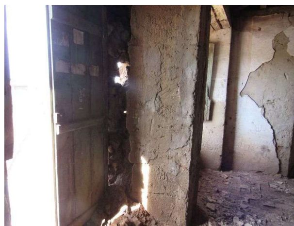
Figural 14 – Deteriorização de reboco no pliar e na parede
