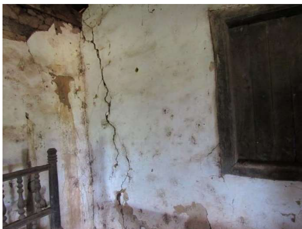
Figural 11 – Rachaduras na parede
