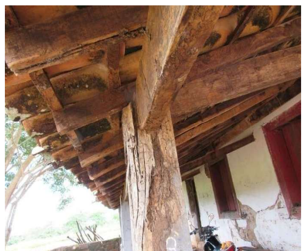
Figura 23 – Pilar de madeira com rachaduras
