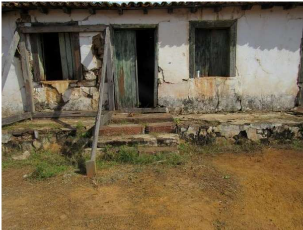
Figural 18 – Foto geral das anomalias nas paredes externas
