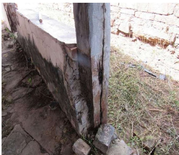
Figura 22 – Anomalia no pilar de madeira
