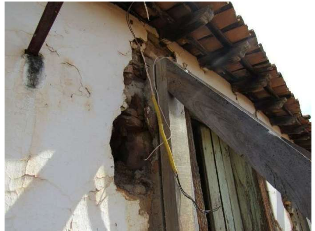
Figural 19 – Foto aproximada da anomalia na parede externa
