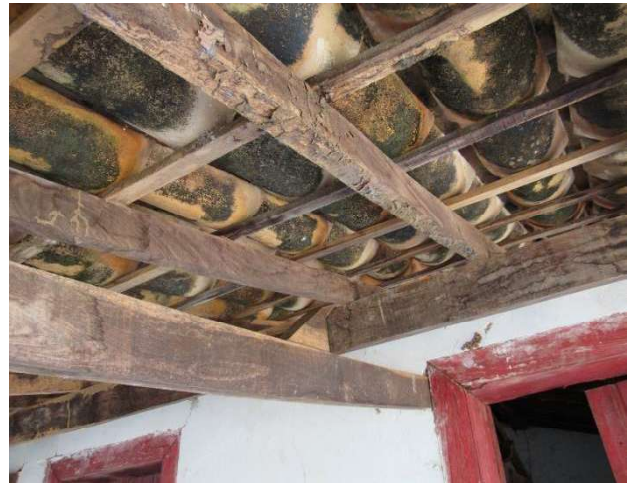
Figura 21 – Anomalias no teto
