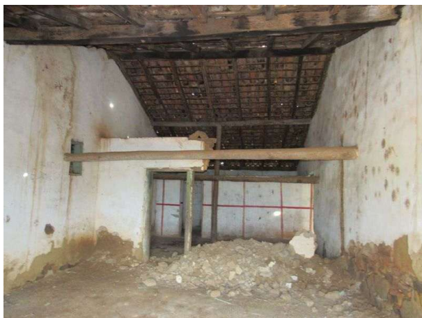
Figura 15 – Colapso de parte da parede
