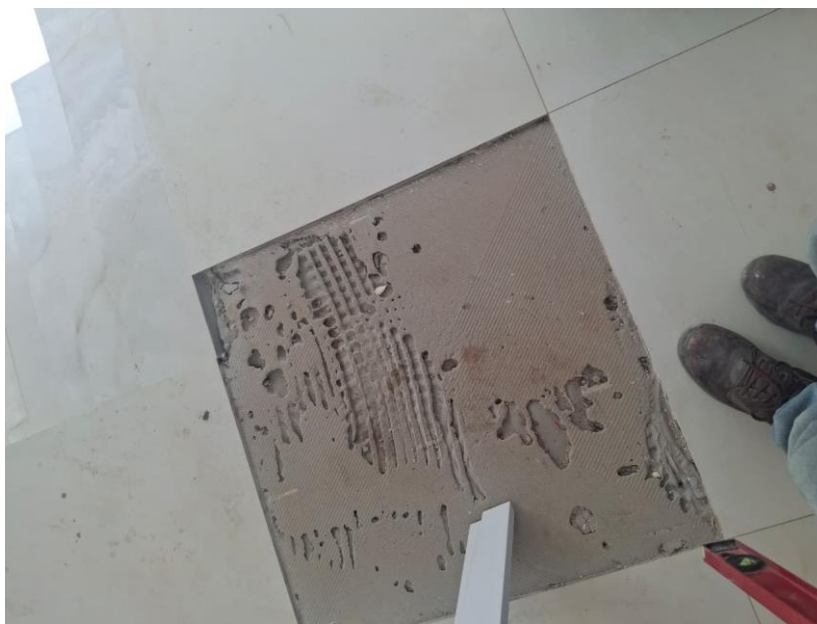
Figura 22: Piso arrancado pois estava fofo – Mão de obra terceirizada.
