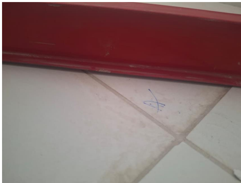
Figura 21: Piso desnivelado – Mão de obra terceirizada
