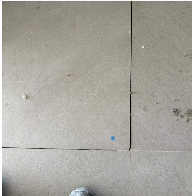
Figura 25: Piso desnivelado – Construtora E.
