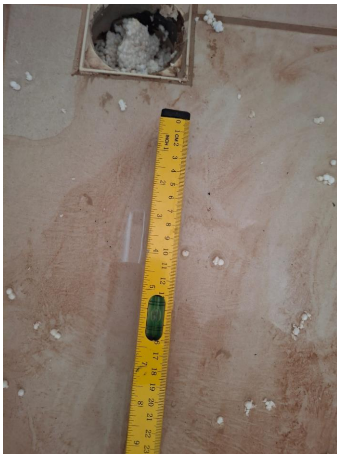
Figura 2: Sem caimento no piso para o ralo.
