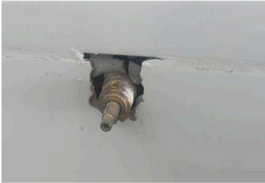
Figura 7: Recorte mal executado.
