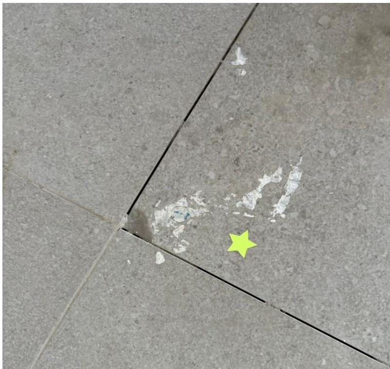
Figura 26: Piso quebrado – Construtora E.
