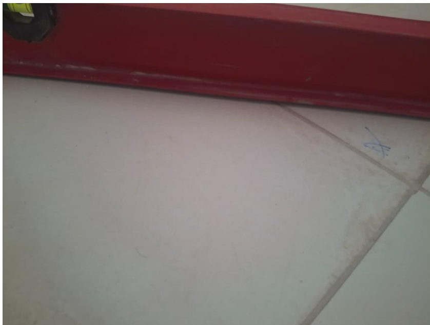
Figura 20: Piso desnivelado – Mão de obra terceirizada
