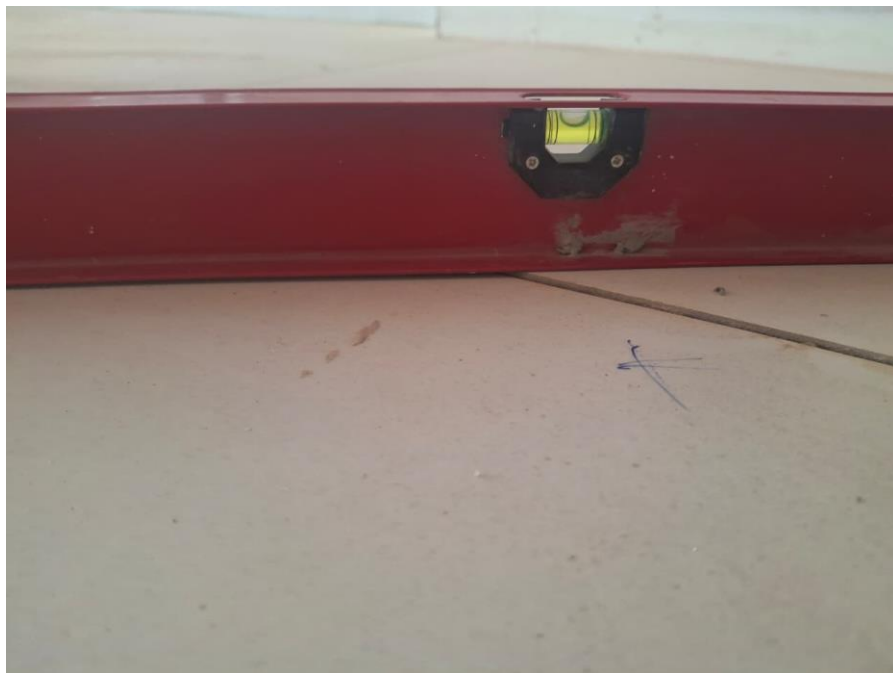
Figura 19: Piso desnivelado – mão de obra terceirizada.
