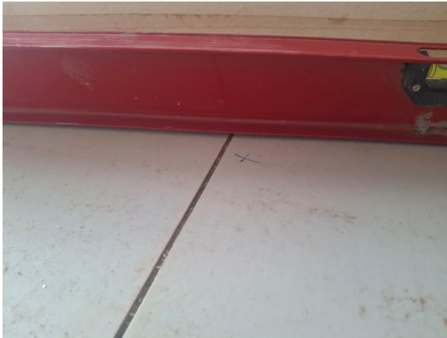
Figura 18: Piso desnivelado - mão de obra direta.
