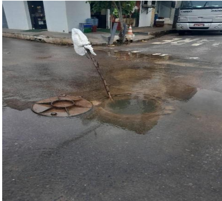
Figura 2: Poço de visita sem tampa.
