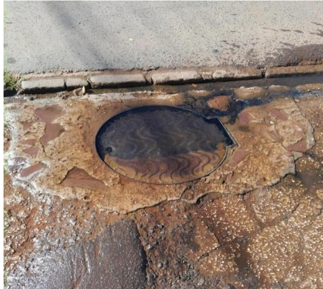
Figura 6: Poço de visita com acúmulo de água e falhas no escoamento.
