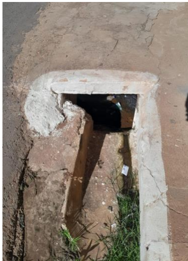
Figura 10: Boca de lobo do P6 presença de resíduos sólidos e sem grade.
