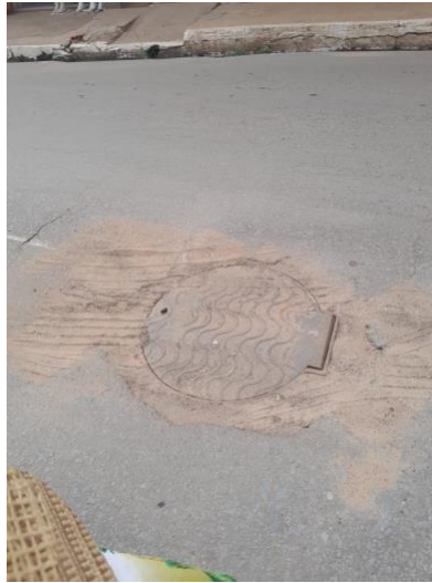
Figura 9: Poço de visita P3 desnivelado em relação ao asfalto.
