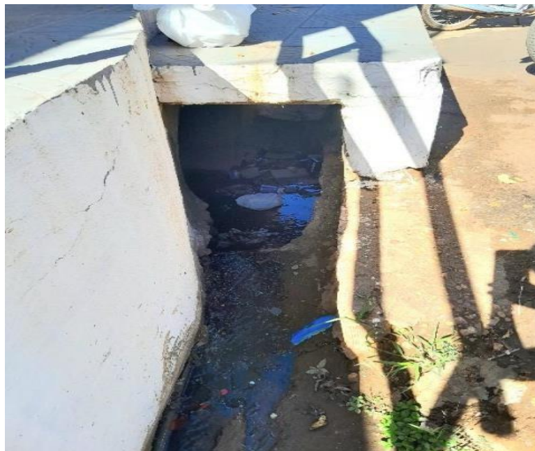
Figura 3: Boca de lobo com ausência de grade de retenção.
