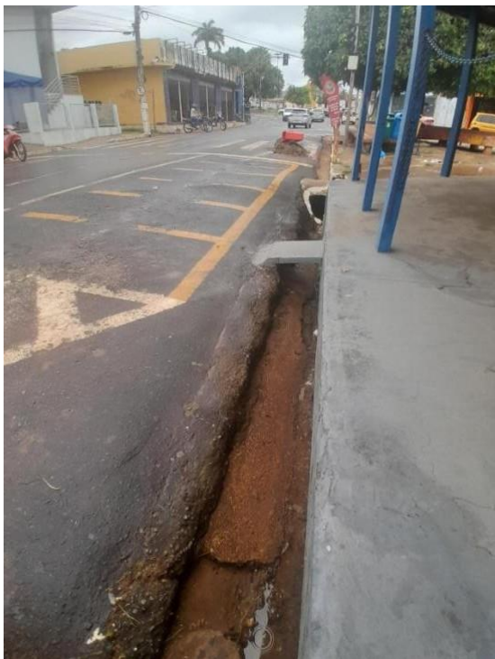
Figura 4: Entulho obstruindo o meio fio.
