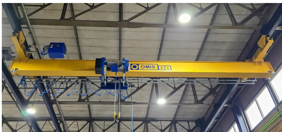
Figura 4 – Ponte rolante suspensa
