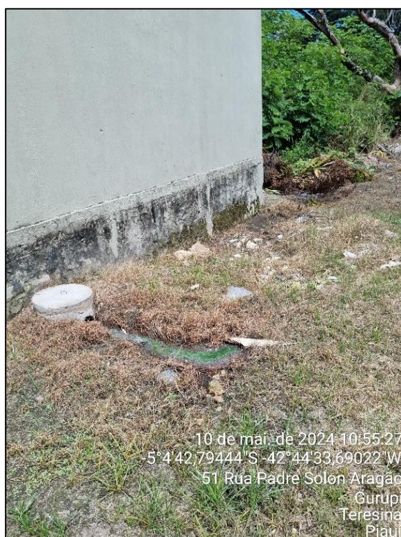
Figura 40 - Efluente sendo despejado na APP na área 06
