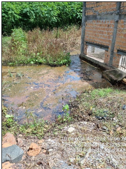
Figura 42 - Inundação em ponto assoreado na área 06
