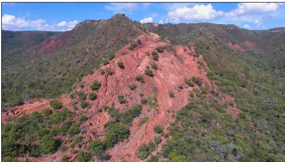
Figura 6. Trecho de obras inacabadas da estrada de acesso a Chapada das Mangabeiras.
