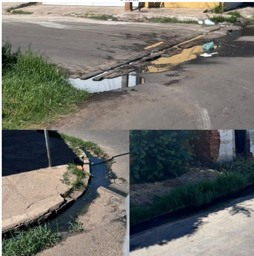
Figura 9 - Mosaico de Esgoto a céu aberto na Travessa Dr. Abílio Costa, em São João do Piauí
