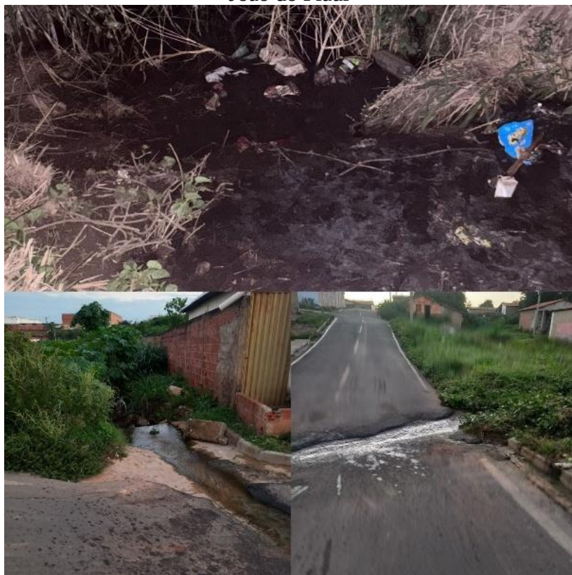
Figuras 7 - Mosaico de Esgoto a céu aberto na Travessa José Torquato Rodrigues, em São João do Piauí
