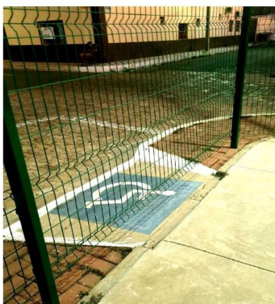
Figura 4: Problemas de acesso de PCD. Fonte: Autores, 2024.
