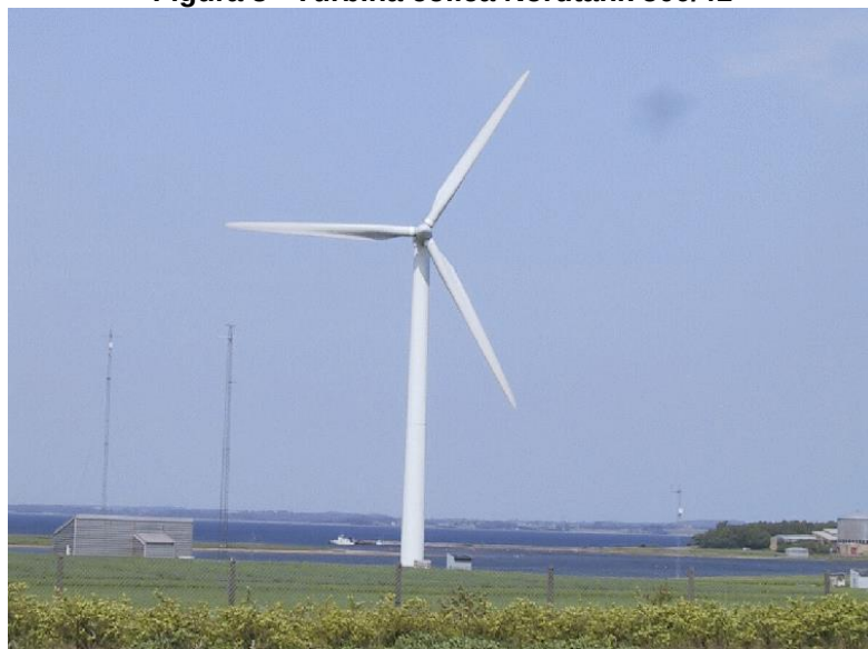
Figura 8 - Turbina eólica Nordtank 500/41
