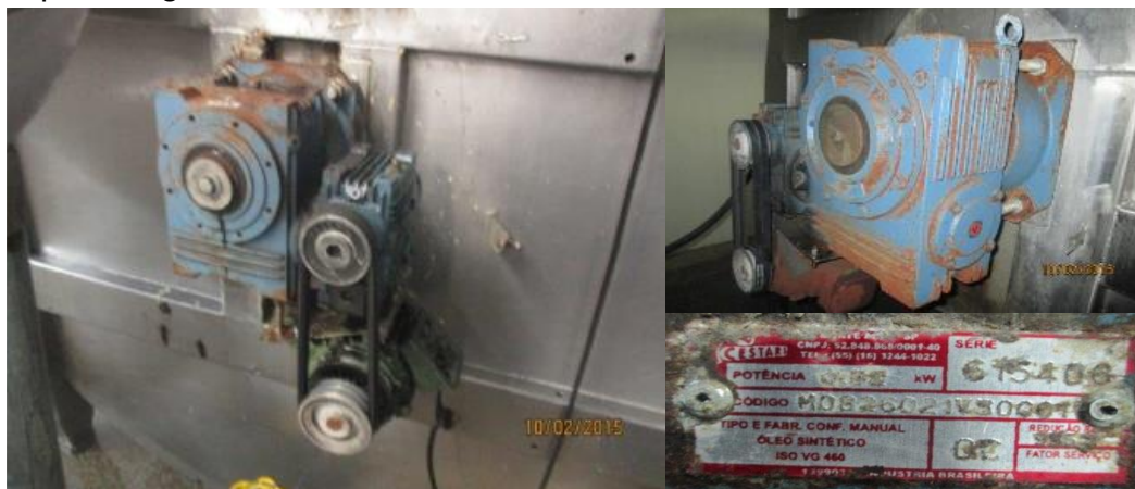
Figura 8 - À esquerda redutor no pré-chiller, à direita redutor no chiller com plaqueta ilegível
