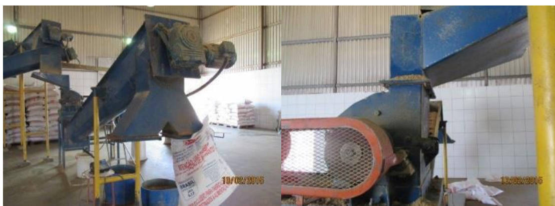
Figura 26 - Rolamentos espalhados no início e no fim das esteiras
