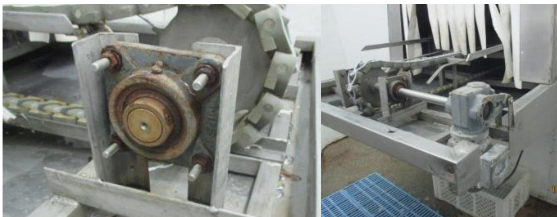
Figura 9 - Rolamentos da Lavadeira enferrujados denunciam pouca proteção contra umidade
