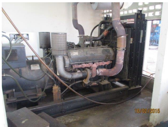
Figura 18 - Dois geradores Stemac foram observados
