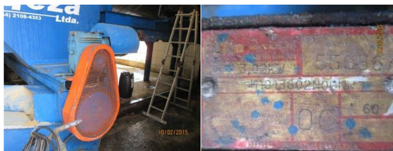
Figura 24 - Corrente enferrujada e plaqueta ilegível do redutor Cestari
