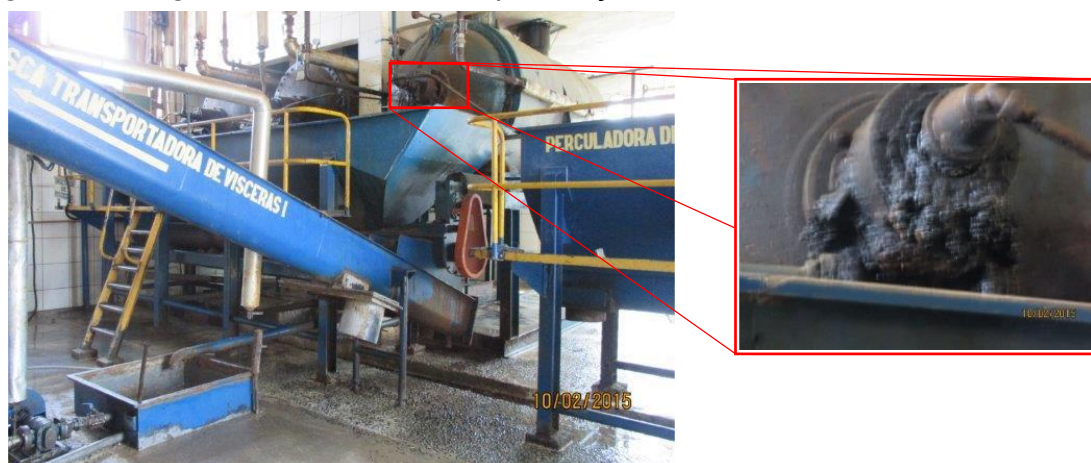
Figura 23 - Digestores, no detalhe a presença de resíduos no rolamento
