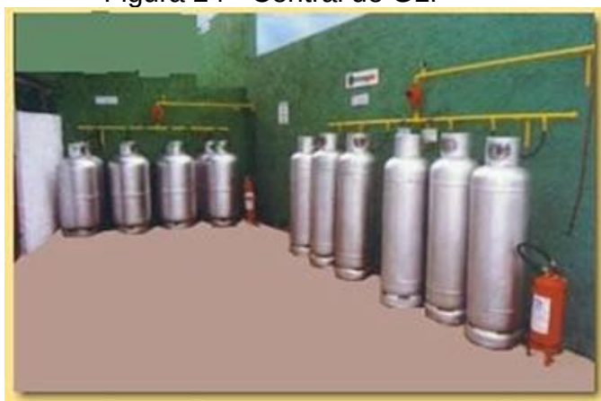
Figura 24 - Central de GLP
