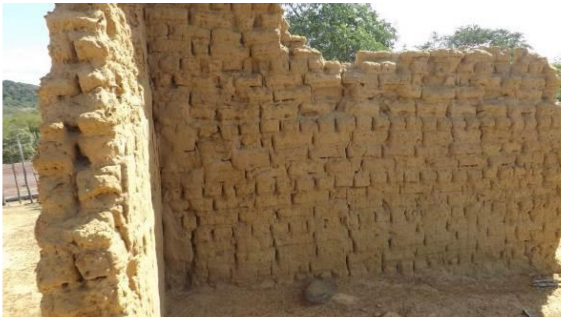
Figura 3.7 Parede de adobe em ruínas
